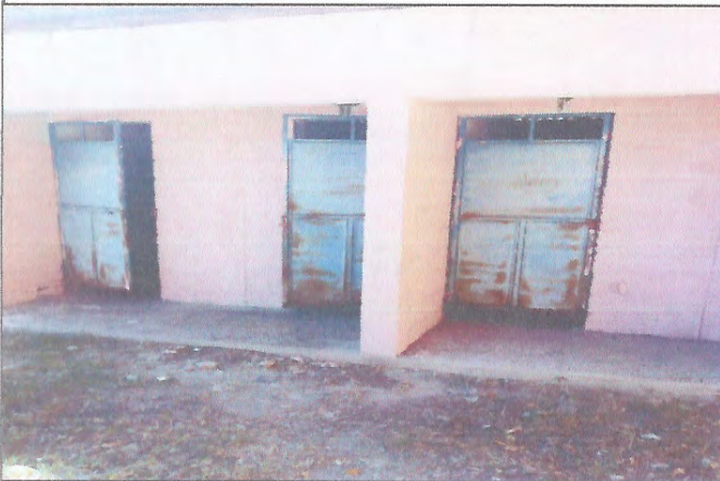
Foto 3: Puertas de baño
